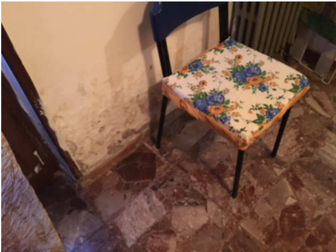
Foto n. 9 – Sala da pranzo- Umidità
